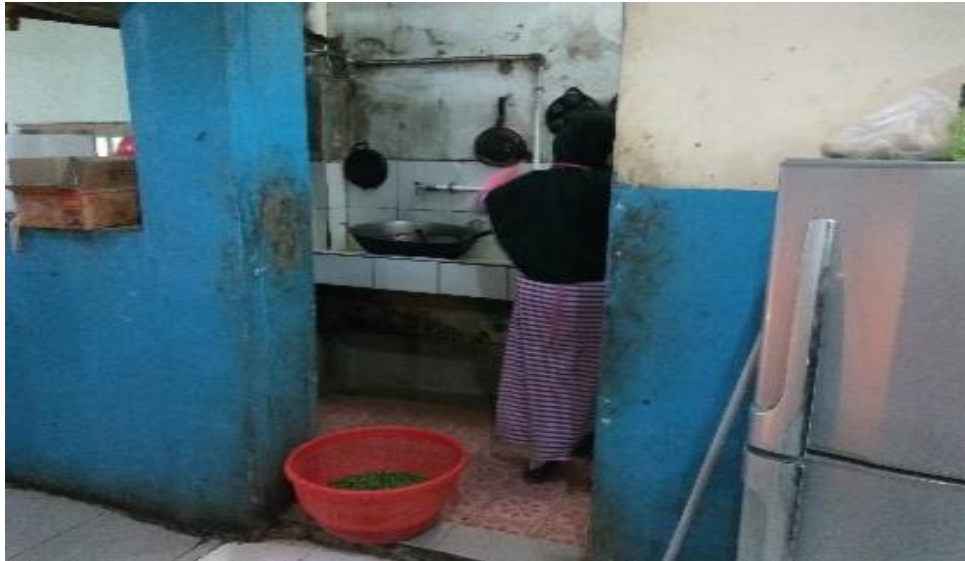
Gambar 10. Tempat cuci piring tidak dilapisi bahan kedap air setinggi 2 meter
