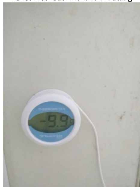
Termometer pada Chiller
