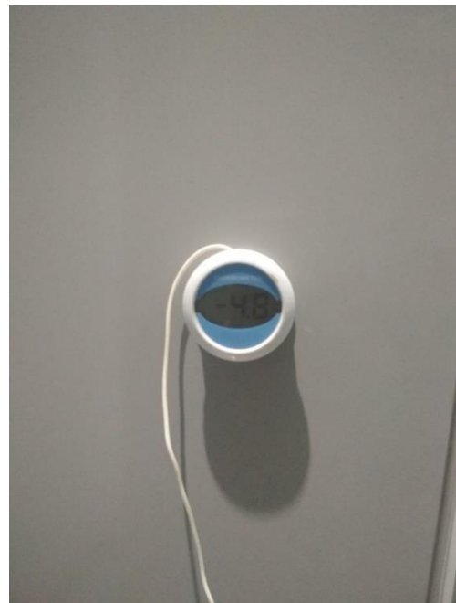
Termometer pada Freezer
