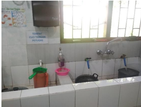
Bak Pencuci di Ruang Pengolahan
